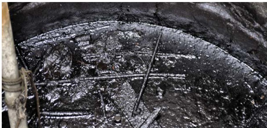
>>> Resíduos de hidrocarbonetos no interior do Poço do Talaminho, situado a cerca de 20 m do estuário do Tejo
